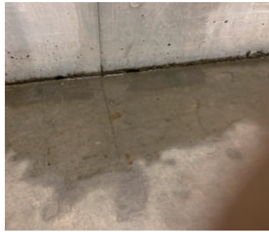
地板、牆角漏水
