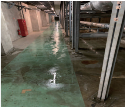
地下水不斷滲漏。
